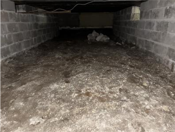
Krypgrund, översiktsbild. Marken är allmänt fuktig, mikrobiell påväxt finns på marken och på blindbotten.
