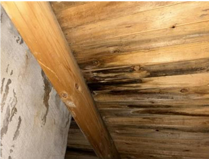
Nockvind: Missfärgningar finns på underlagstaket i anslutning till murstock, torrt vid besiktningstillfället.
