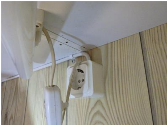
Felaktigt utförda elinstallationer.
