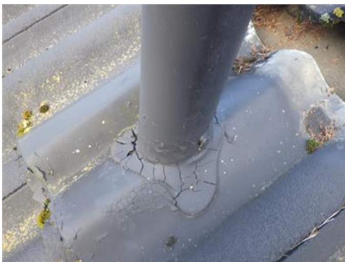
Torkad tätning vid avloppsluftare.
