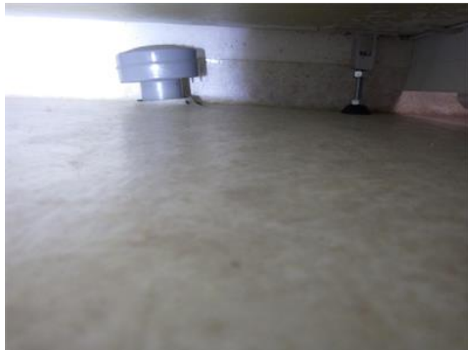
Otät genomföring i golv i duschzon.
