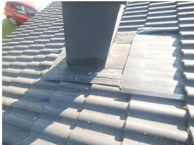
Färgsläpp på plåtdetalj tak.
