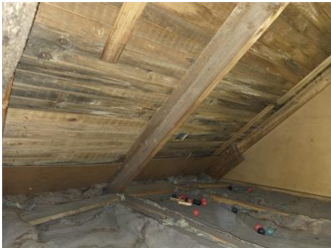
Exempel på missfärgningar/påväxt i underlagstaket på vind.
