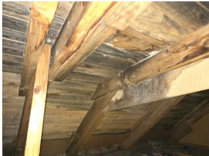
Exempel på fuktfläck/påväxt i sidovind.
