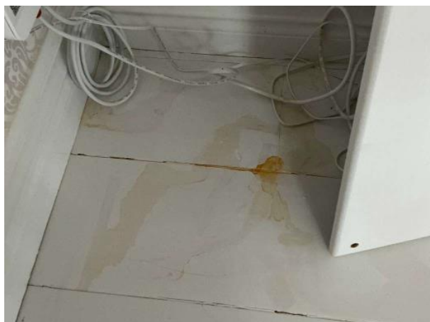
Bild 6: Invändigt, Entréplan, Orangeriet. Fläckar noterades på golvet vid golvvärmefördelaren. Inbyggda vattenkopplingar saknar dräneringsrör
