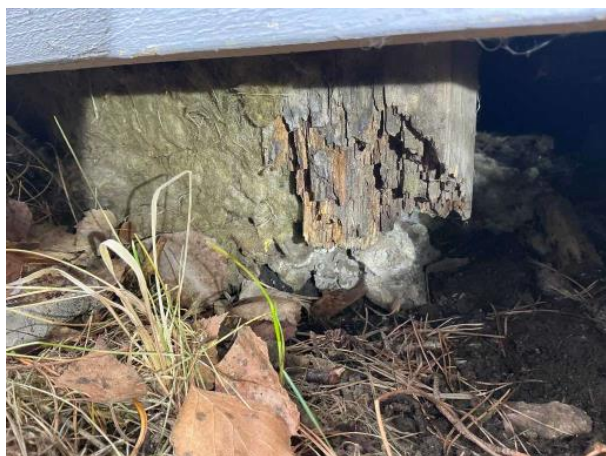
Bild 7: Utvändigt, Mark, Grund, Inbyggd plintgrund Grunden är marknära monterad (endast besiktad från åtkomliga delar från fasaden) En rötskadad stolpe noterades
