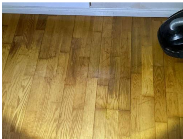
Bild 8: Invändigt, Entréplan, Allrum, Ojämna golv noterades Fuktfläck noterades på golvet (torrt vid besiktningsstillfället)
