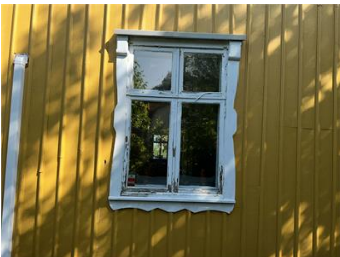
Fönster: Flertal fönster behöver ses över.
