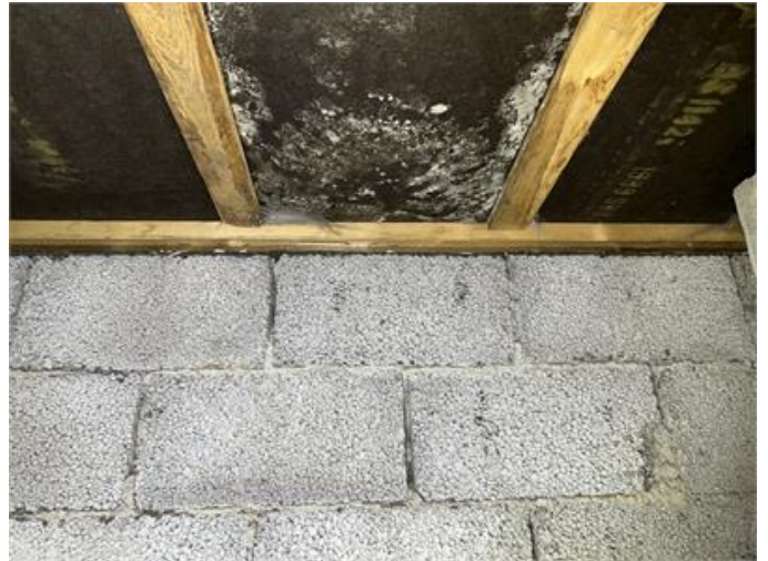
Krypgrund Västdel: Mikrobiell påväxt på blindbottensskivor.
