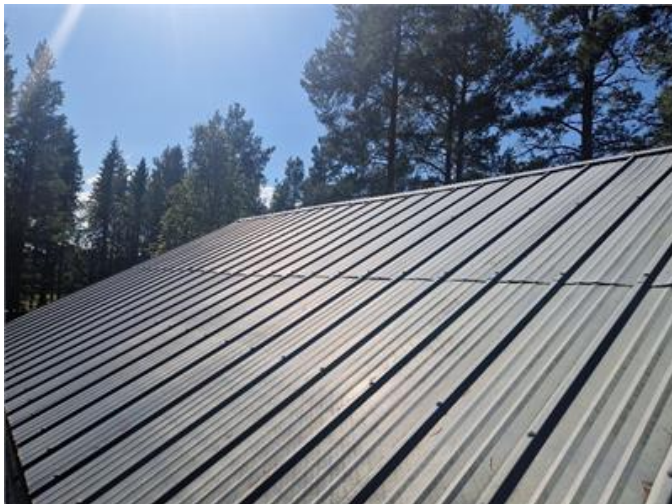
Äldre spikad pannplåt enstaka infästning kryper.
