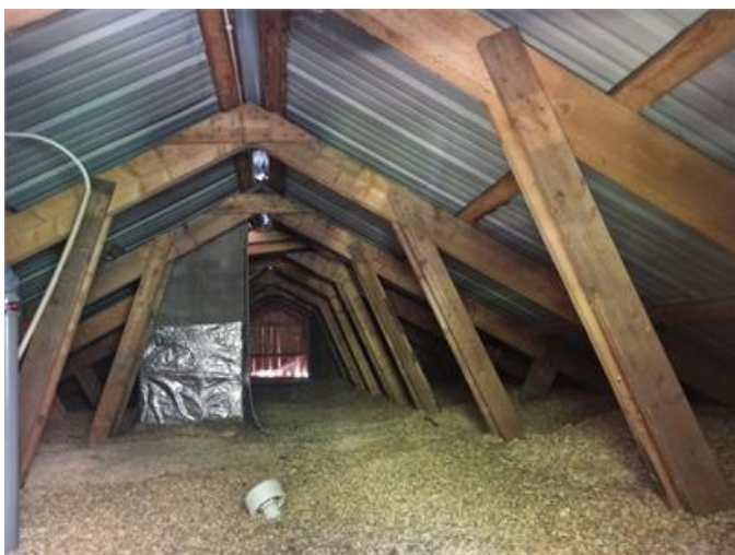
Vind, underlagstak/kondensskydd saknas.
