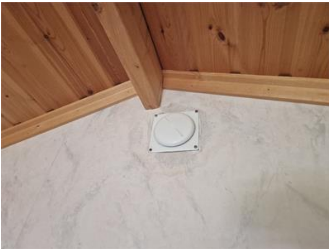
Missfärgning/fuktfläck vid ventil
