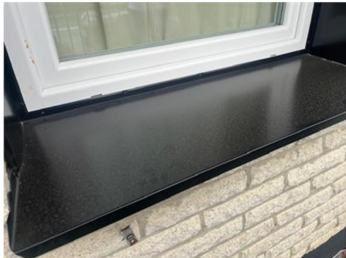
Fönstren är monterade djupt i fasad vilket medför bristfälligt lutning på fönsterbleck.
