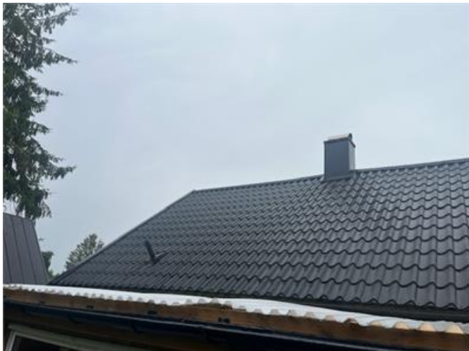
Plåthuv till avloppsavluftningen behöver justeras
