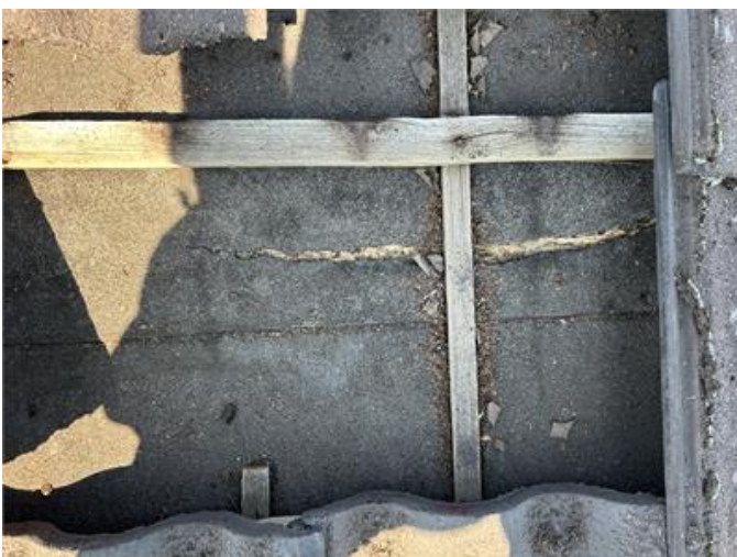
Tak: Sprucken papp noterades vid stickkontroll.
