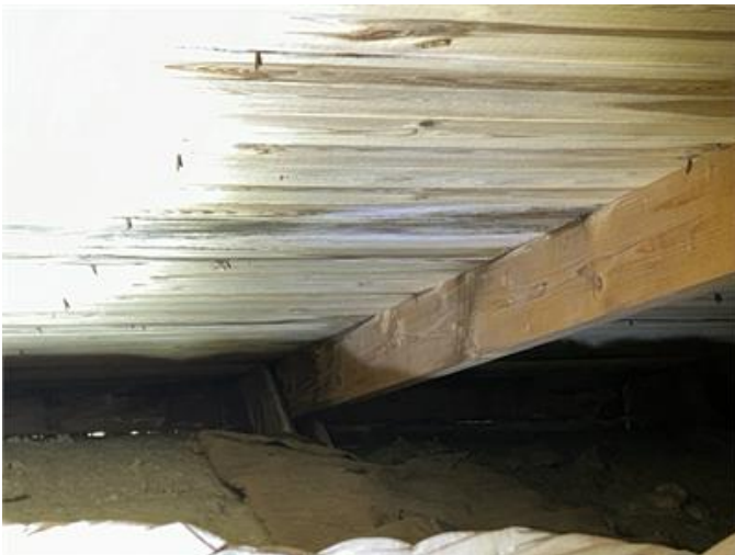
Nockvind: Mikrobiell påväxt noteras på underlagstaket.
