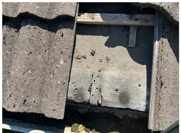
Tak: Torr och sprucken papp vid takfoten.
