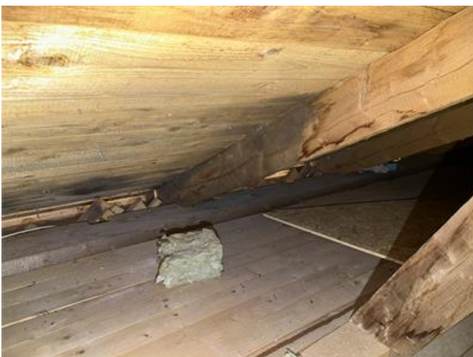
Sidovind söder: Fuktanvisning samt mikrobiell påväxt noteras på takstolar och underlagstaket.
