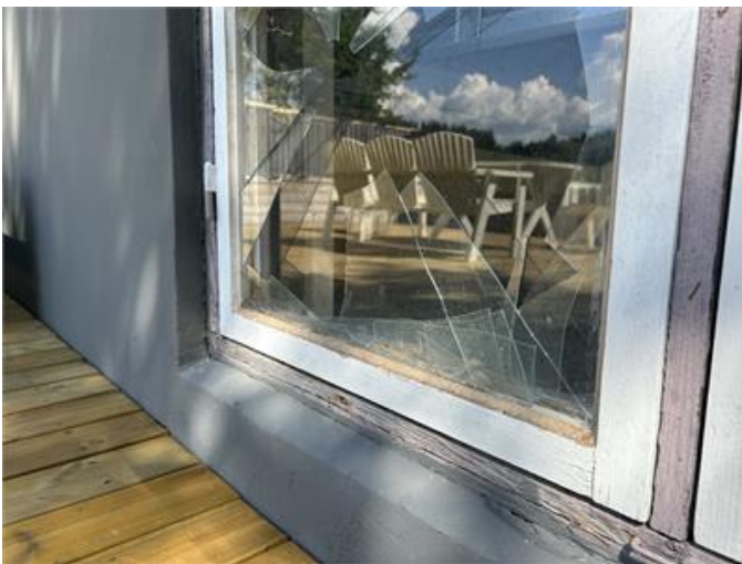
Fönster: Sprucket glas samt underhållsbehov.
