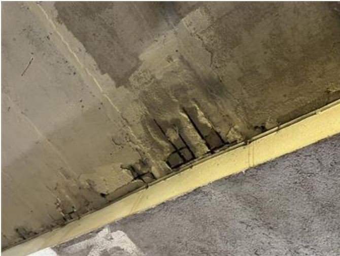
Källare: Fuktanvisning i taket, synliga armeringsnät samt putssläpp.
