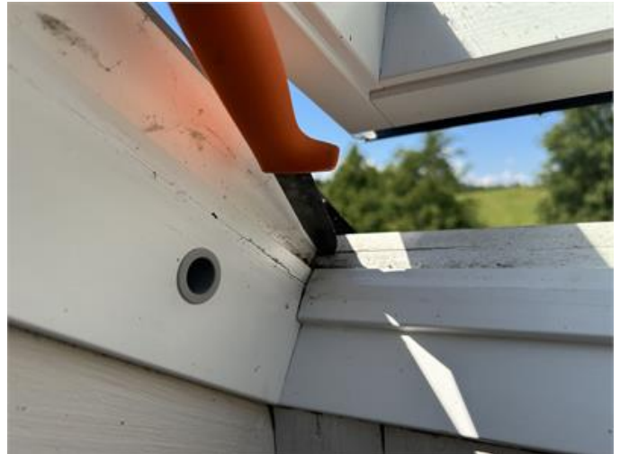
Fönster: Rötskada i takfönster på norrsidan.
