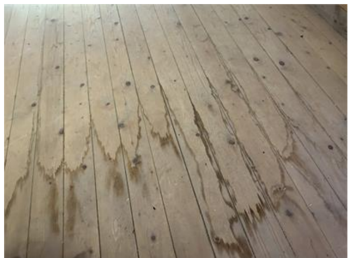
Sidovind norr: Fuktanvisningar på golvet.
