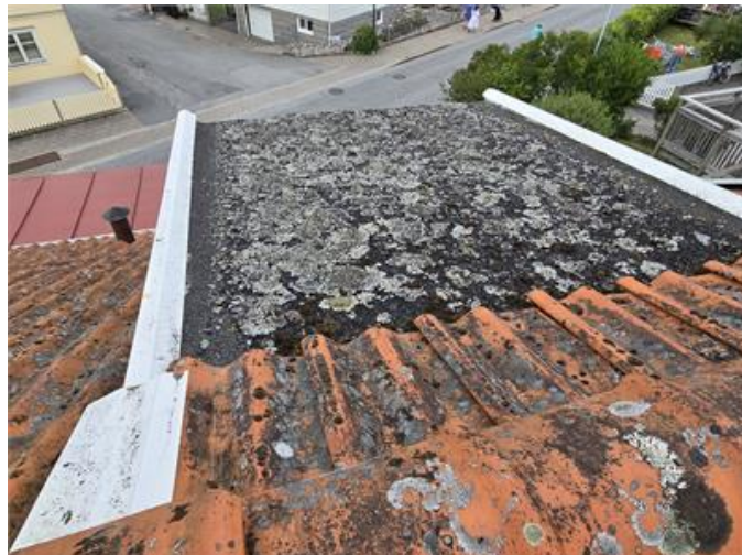
Tak: Mossa på takkupa.
