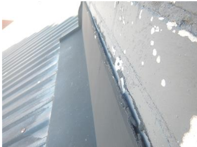
Otätthet mellan murstock och vindskiveplåt.
