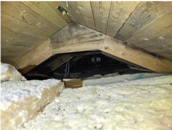
Nockvind: Mikrobiell påväxt noteras, framförallt ovan tillbyggnad.
