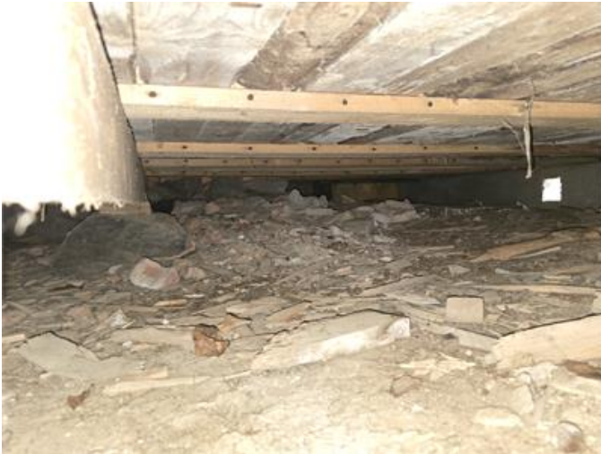
Krypgrund: Översiktsbild, byggspill/organiskt material på marken.
