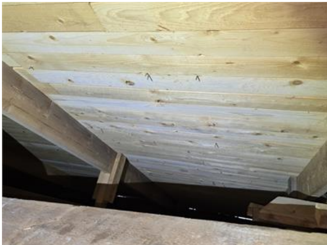
Nockvind: Ytlig vitaktig mikrobiell påväxt på underlagstak.
