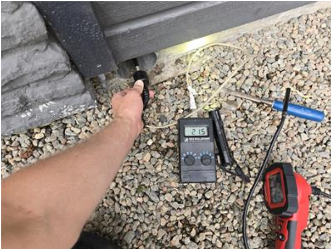
Bilden visar fuktmätning via en ventil in under delen i tvättstugan (tillbyggnaden mellan garage/bostad). Utrymmet är inte fysiskt åtkomligt.
