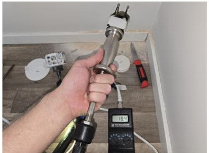
Bilden visar fuktmätning i ytterväggssyll, sovrum 1.
