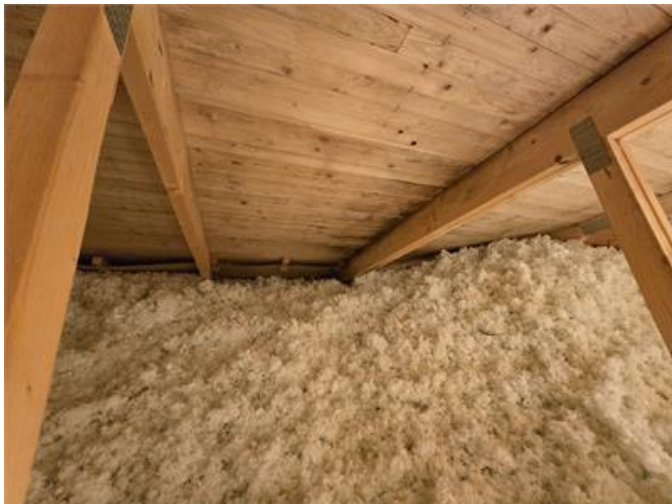
Nockvind: Mikrobiell påväxt i underlagstak, dock behandlat.
