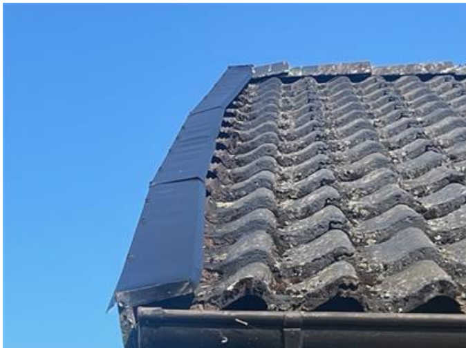
Vindskena/vindskeveplåt har slagit sig och släppt från infästning.
