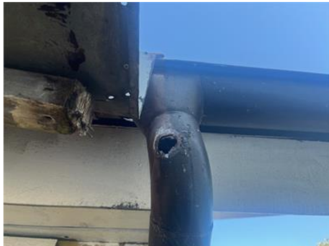
Takavvattning i behov av åtgärd.
