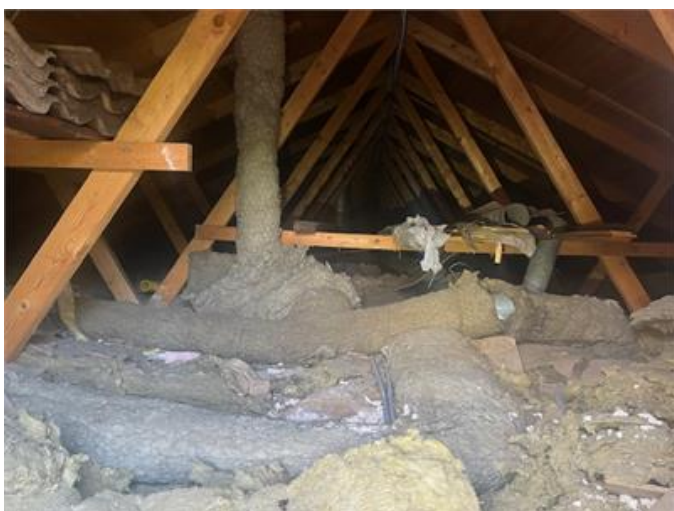
Det bör undvikas att trampa på ventilationsrör som finns i utrymmet. Ventilationsrör och dess isolering har trampskador.
