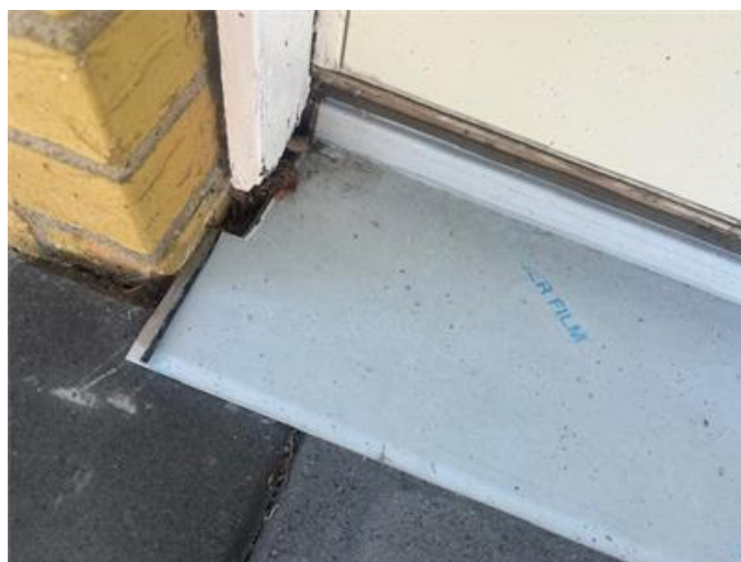
Tröskelbleck till entrédörr saknar uppdagna gavlar. Tätning bör utföras.
