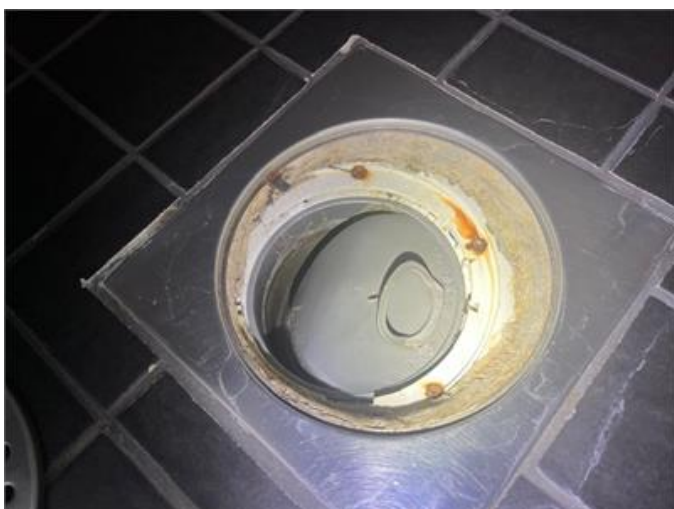
Klämringen är skruvad med fel skruv som börjat rosta.
