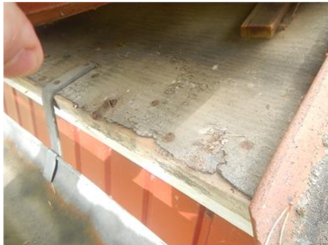
Takpapp som är spröd och torrsprucken.
