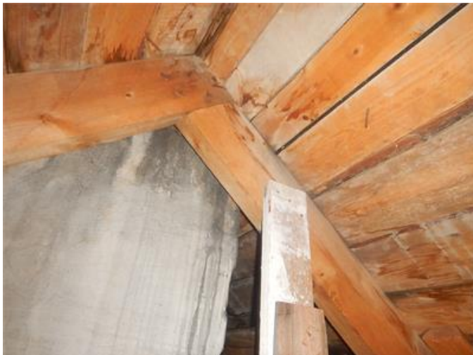
Fiuktfäckar på underlagstak och rinnmärken på murstock vind.
