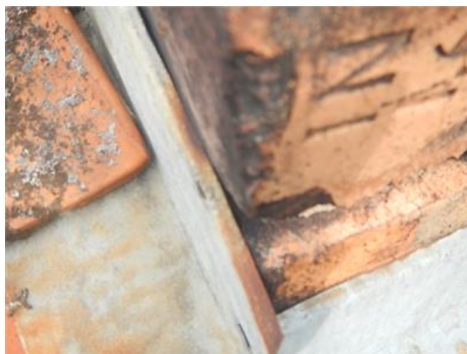
Otäthet mellan murstock och skorstensbeslag.
