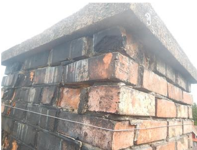
Skorsten som eroderat.
