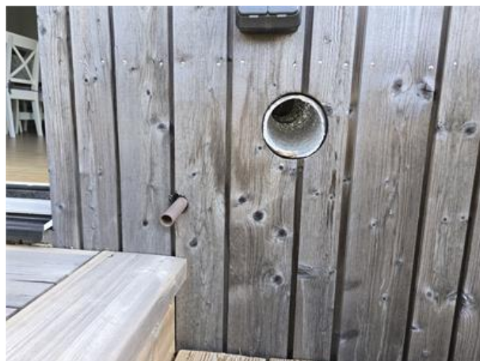
Tilluft till kamin.
