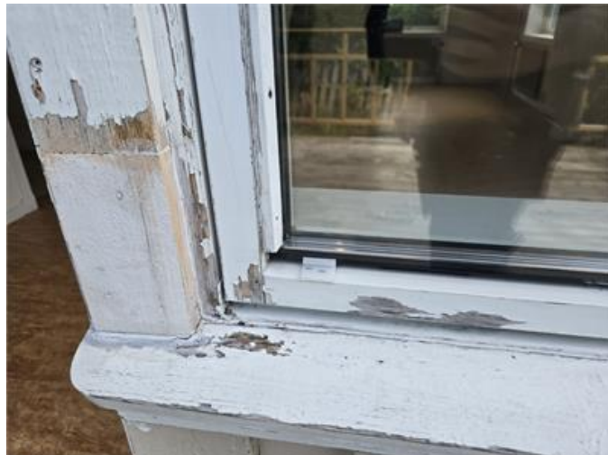
Fönster: Exempelbild på fönster med underhållsbehov.
