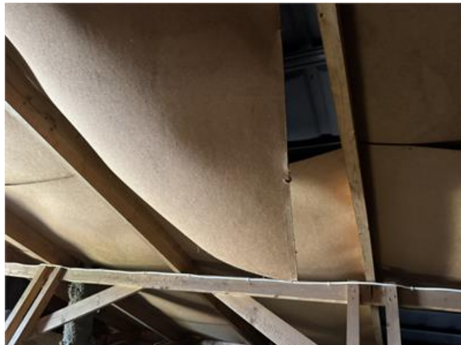
Underlagstak av mosonitskivor har lokalt lossnat.
