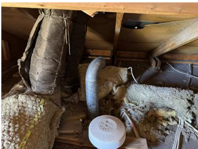
Ventilationsrör mynnar i vindsutrymmet.
