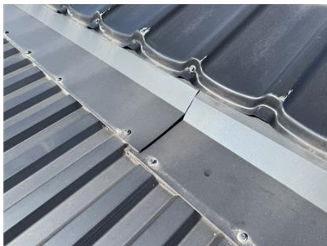
Anslutningsplåt har bristfälligt överlapp.
