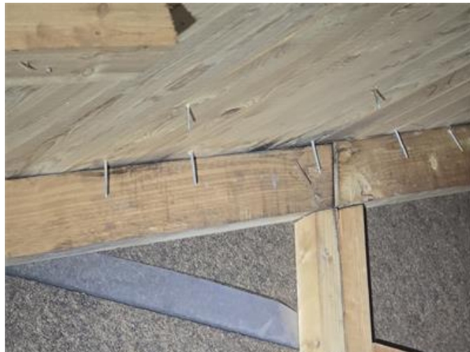
Lokal fuktfläck/missfärgning, underlagstak vind.
