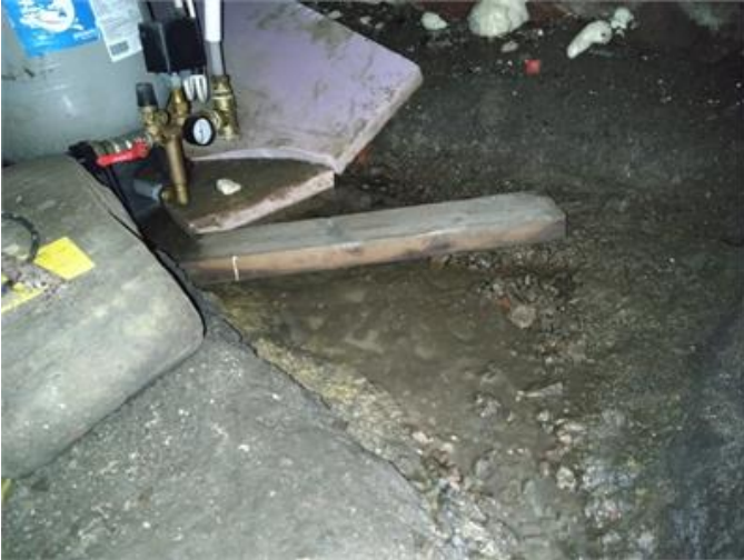
Vatten på mark i grund två
