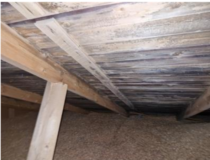
Mikrobiell påväxt/konvektions skador noteras ovan dusch/sovrums.
