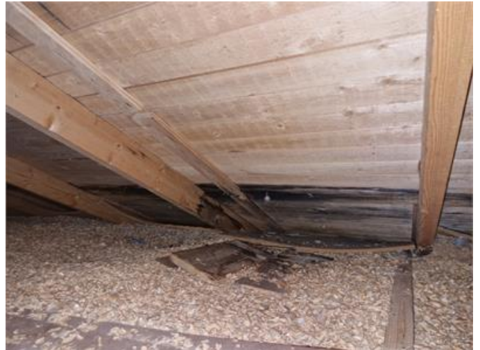
Inläckage noteras genom underlagstak.
