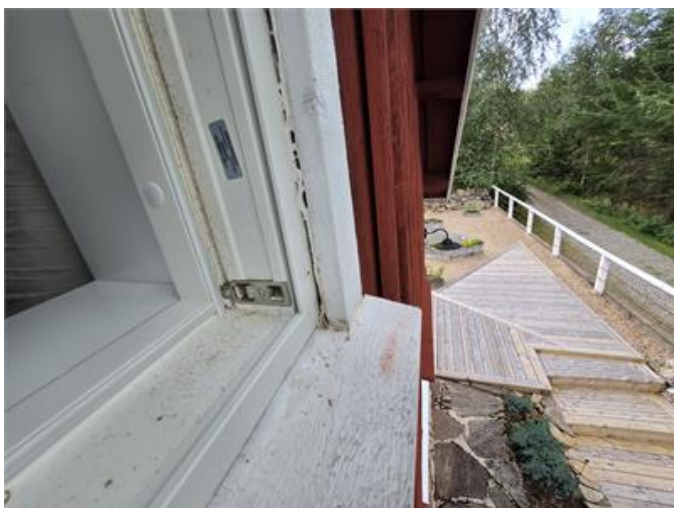
Fönster: Exempelbild på otätheter samt fönsterbleck av trä.
