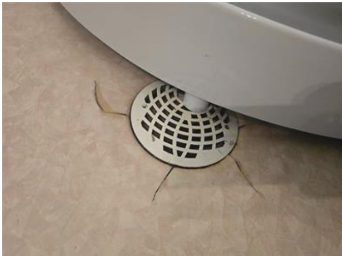
Skador i plastmatta kring golvbrunn, dusch/wc.
