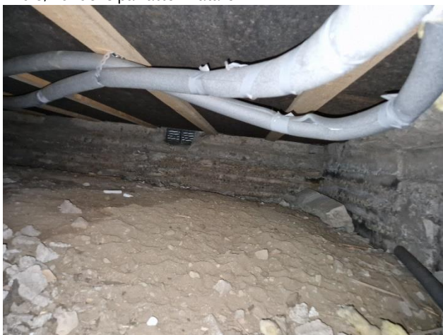
Bild 5, vy äldre del av kryppgrund, kalk/salt utfällning grundmur. Utrymmet gick ej att beträda
