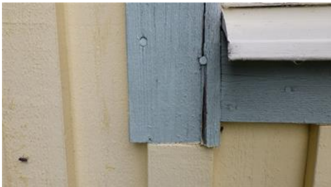
Torrsprickor i fasadpanelen
