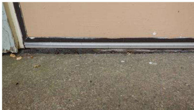
Tröskel utan tröskelplåt
