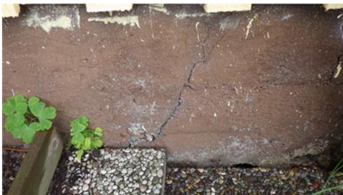
Spricka i sockeln
