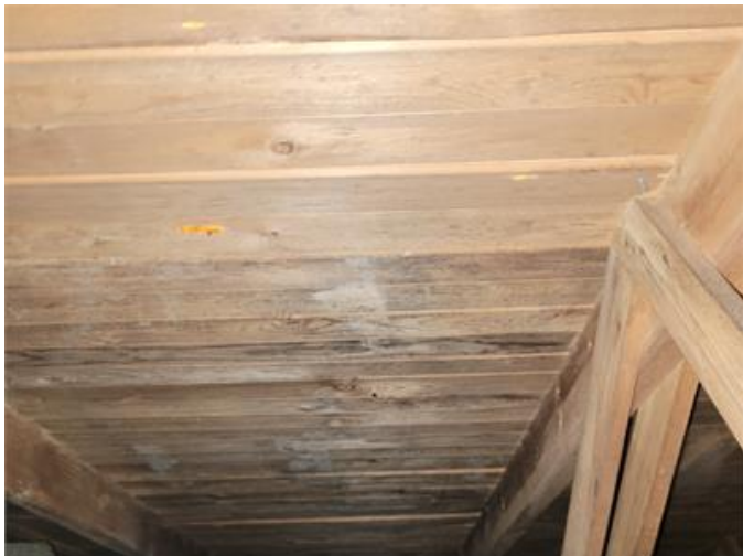
Mikrobiell påväxt på underlagstak
