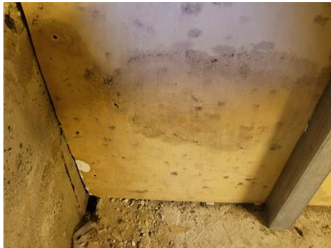
Mikrobiell påväxt på väggar i krypgrund
