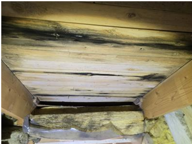
Nockvind: Mikrobiell påväxt noteras på underlagstak.
