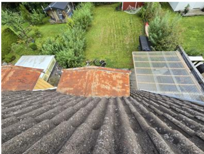
Tak: Översiktsbild på rostiga takkupor.
