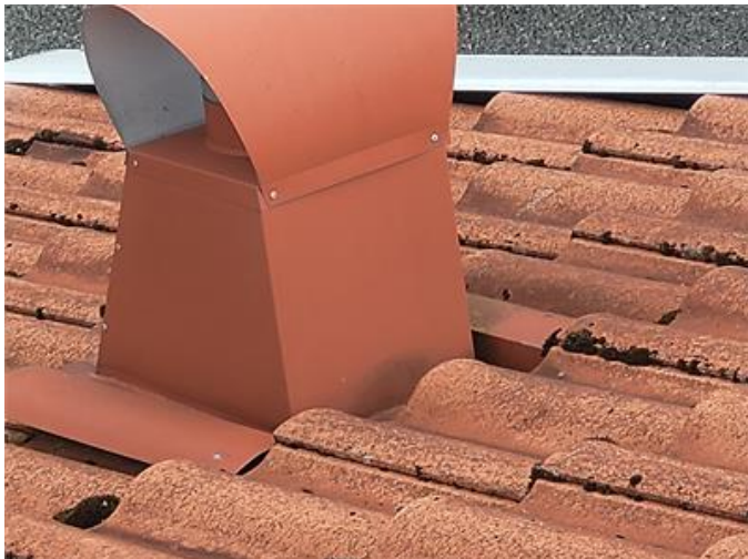
Plåthuv bör kontrolleras och justeras
