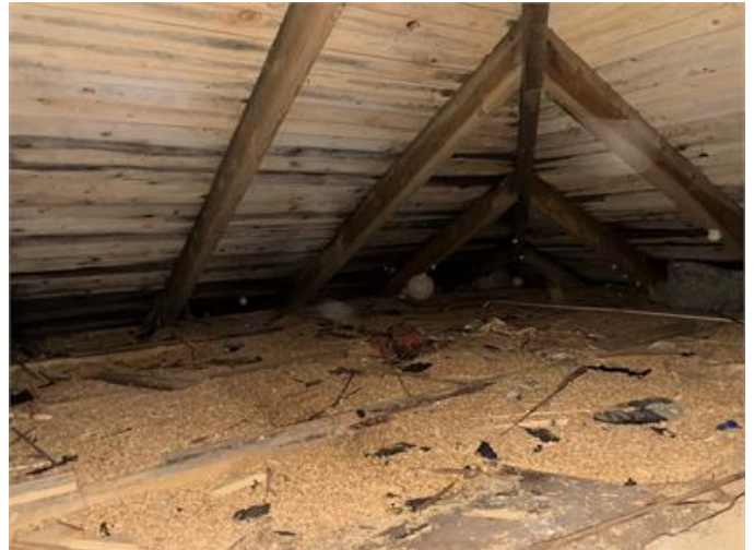
Nockvind: Mikrobiell påväxt noterades på underlagstaket/takstolar.
