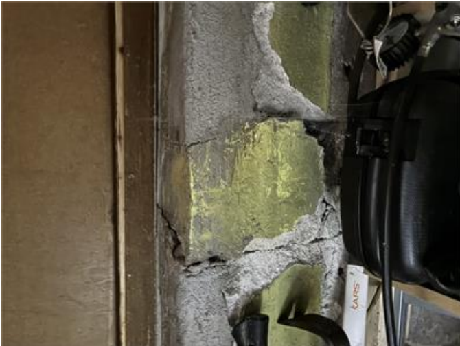
Sockel/grundmur: Lösa stenar finns i grundmur vid källardörr där stödmur vid källartrappa har sättningar.
