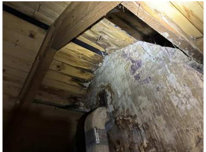
Nockvind: Missfärgningar finns på taket, bl.a i anslutning till murstock.
