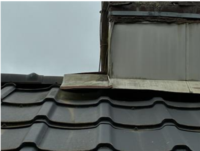
Tak: Begynnande rost finns på takplåten. Skorstensbeslag sluter ej tätt mot takplåten.
