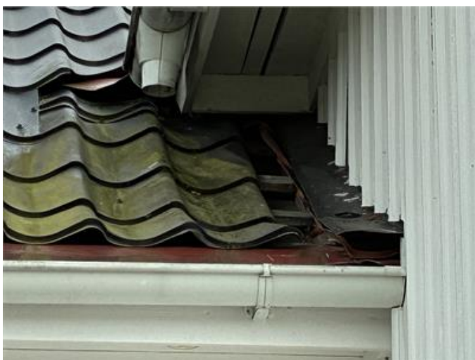
Tak, Plåtbeklädnad saknas lokalt.
