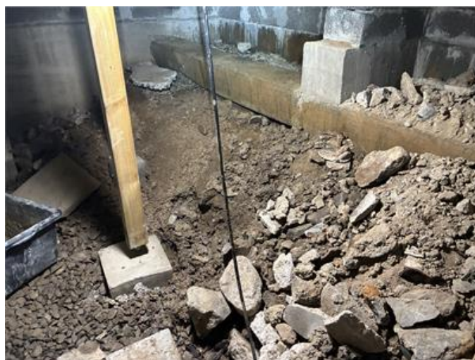
Krypgrund: Fuktiga partier noterades på marken i utbyggnad, fuktgenomslag nertill på grundmur ovan balk.
