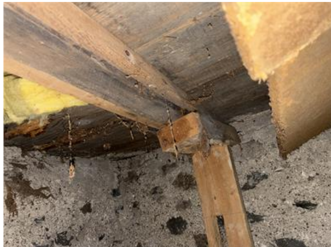
Källare: Exempel på rötskadad golvbjälke.
