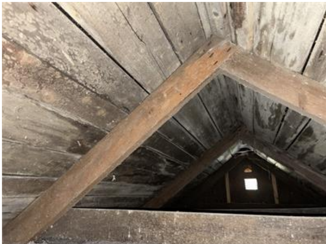
Nockvind, Norr: Mikrobiell påväxt på underlagstak och takstolar.
