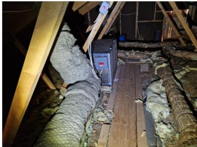
Ventilationsaggregat på vinden
