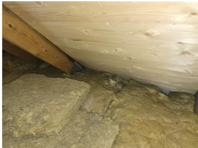
Exempel frånnockvind. Mikrobiell påväxt bör kontrolleras regelbundet, främst vintertid för ev. förändringar. Säljare har inte noterat några förändringar sen utförd takomläggning och ny råspont.
