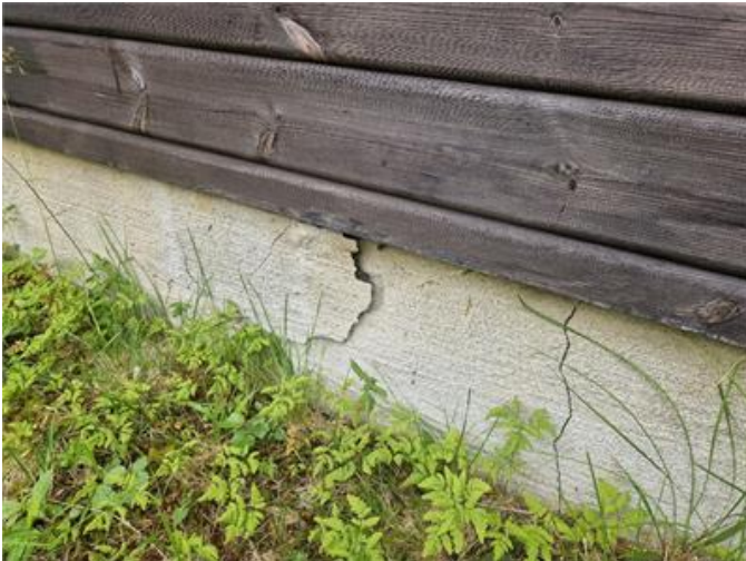
Sprickor och frostsprängning noteras på sockel.
