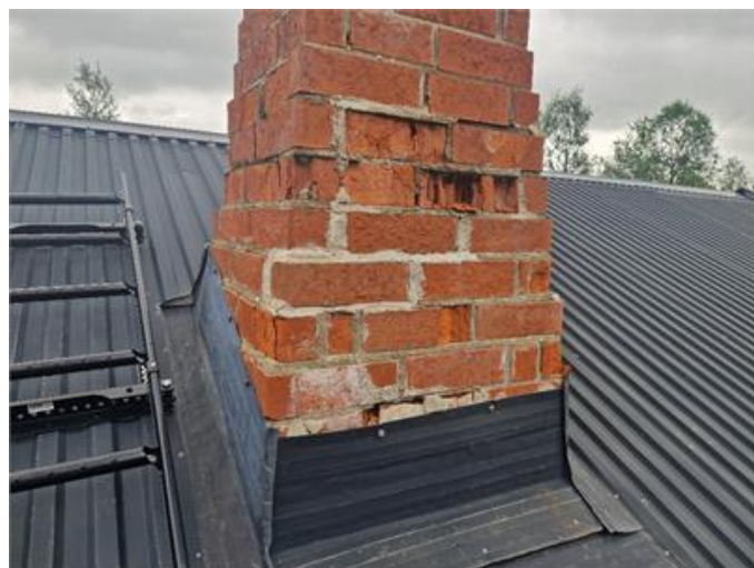
Frostsprängning och otätheter noteras vid/på murstock.
