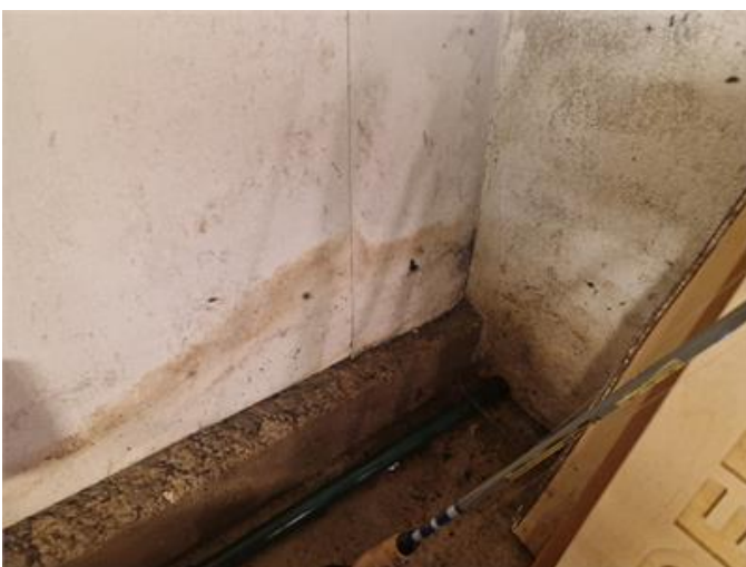
Fuktgenomslag på påreglade källarytterväggar.
