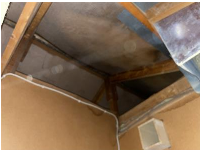
Lokala fuktmärken på underlagstak
