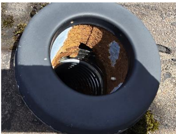
Tak: Rostskador i rör på avluftarhuv, bör åtgärdas.
