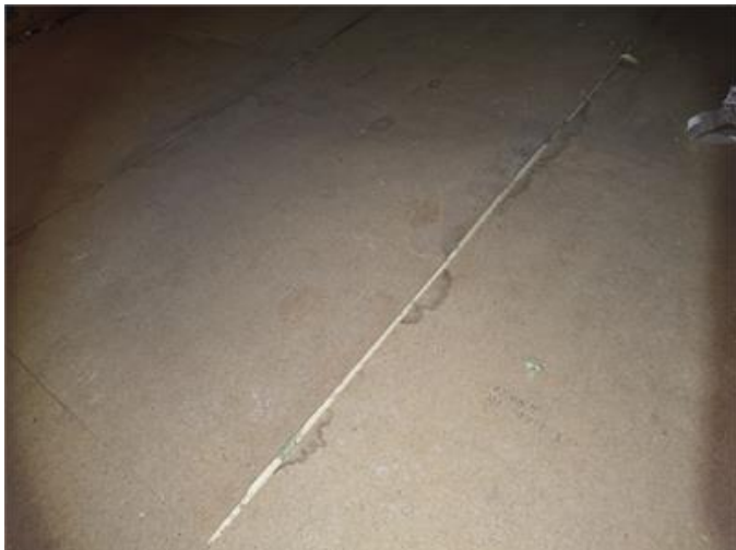
Nockvind: Fuktfläckar noteras på golv, möjligtvis kondensrelaterade, håll under uppsikt.
