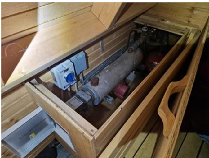
El patron för värme installerad under sittbänk i bastu
