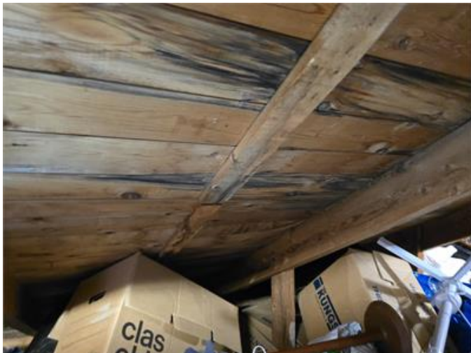
Exempel på missfärgning i underlagstak.
