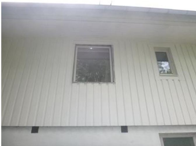
Bilden visar fönster där plåtdetaljer/foder inte finns.
