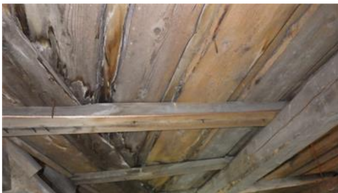
Missfärgningar lokala rötskadornockvind.
