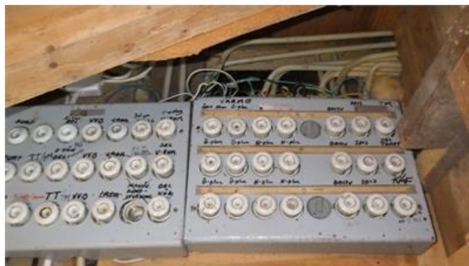
Enkelisolerade elinstallationer, ej petskyddad elcentral.
