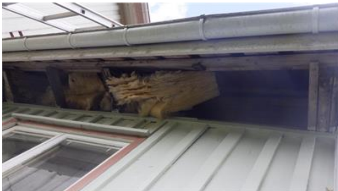
Taksims bör åtgärdas.
