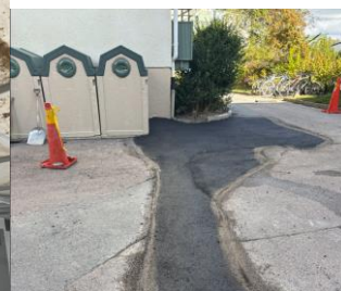
Asfalt efter stora läckan
