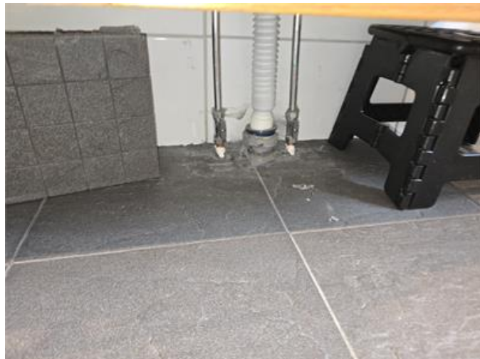
Bilden visar genomföringar i golv.
