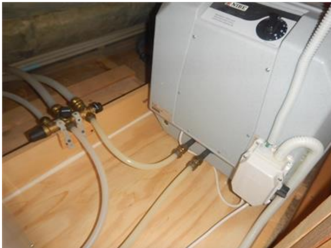
Varmvattenberedare ej fuktsäkert placerad.
