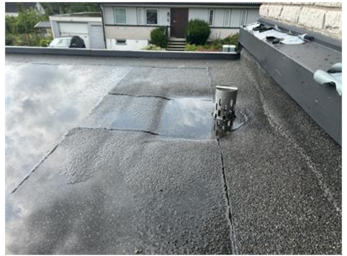
Garage tak: Stående vatten.
