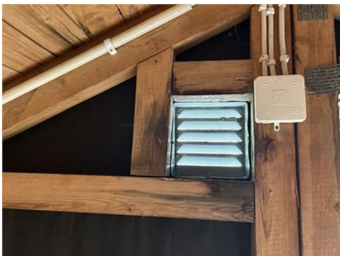
Nockvind: Fuktanvisning runt ventil.
