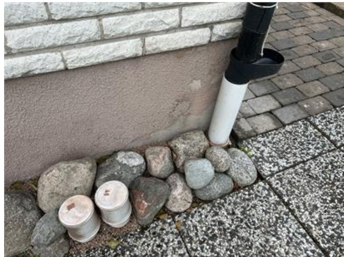
Sockel/Fasad: Färg/Putssläpp på sockel samt mindre sprickor i fasaden.
