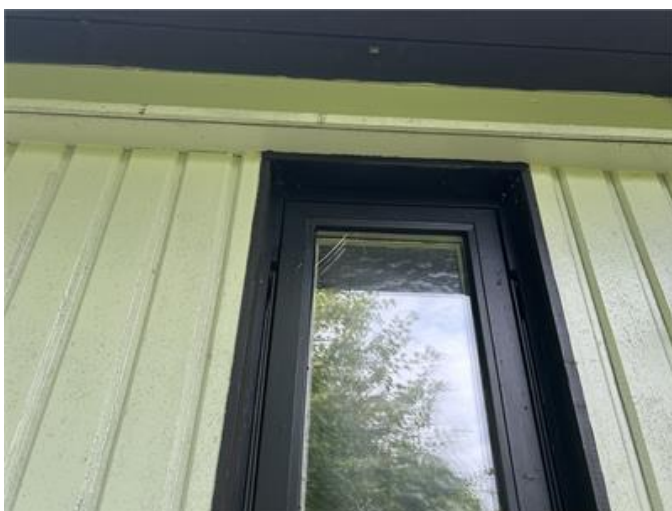
Fönster: Spricka i fönster.
