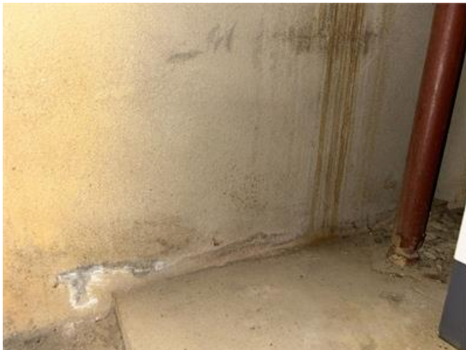
Sutterängkällare: Salt/kalk utfällning i grundmur.
