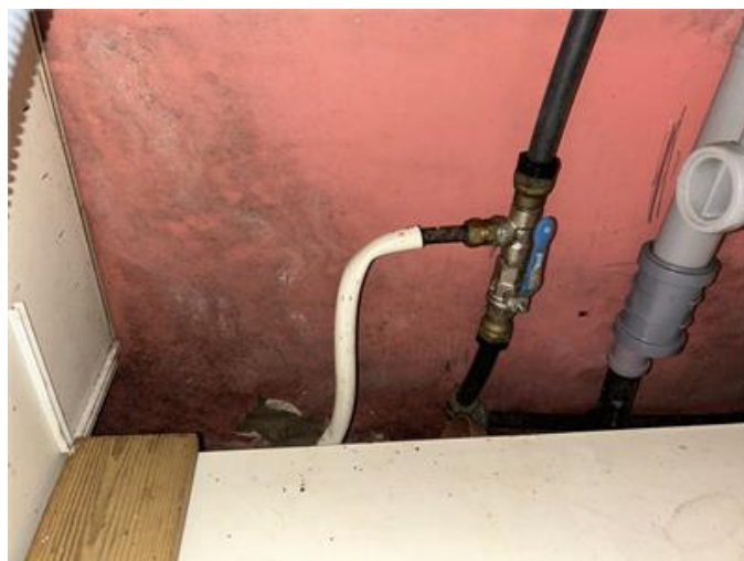
Källare: Mikrobiell påväxt på bl.a. gipsskivor i Tvätt.
