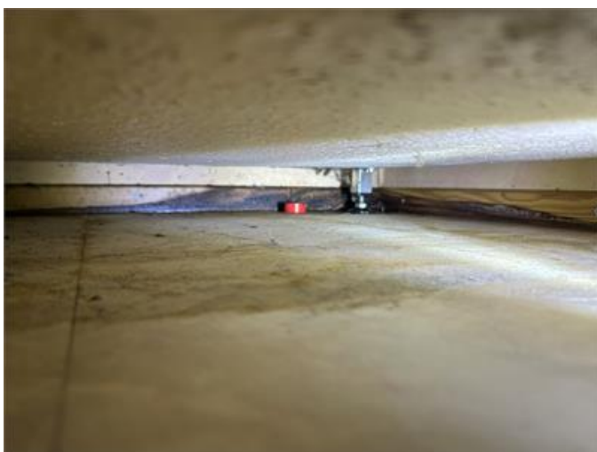
Dusch/WC: Under duschkabin.
