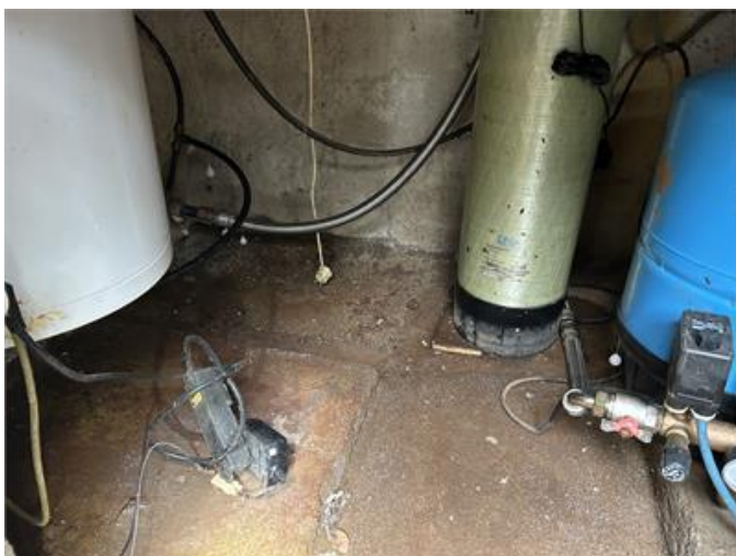
Källare rum: Vatteninstallationer i utrymmet.
