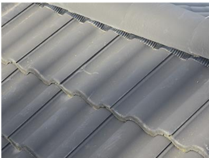
Exempelbild, defekt takpanna.
