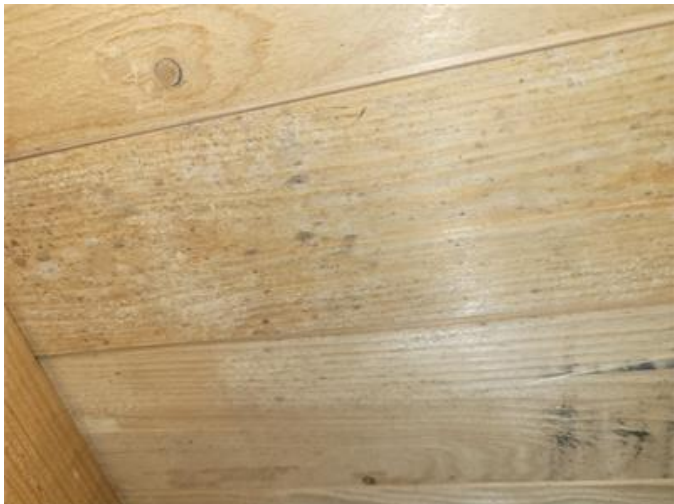
Mikrobiell påväxt förekommer i begränsad omfattning
