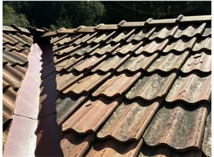
Tak: Nockpannor är ej fastsatta. Frostskaade pannor förekommer. Enstaka panna sprucken och behöver bytas.
