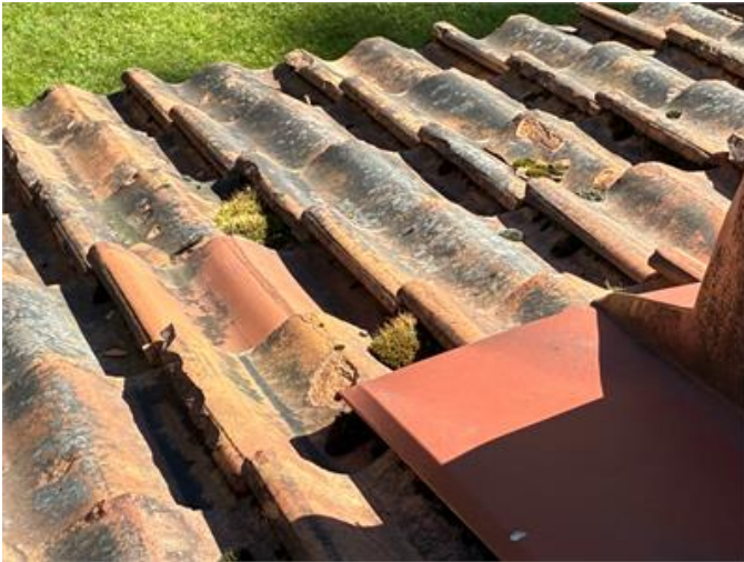
Tak: Begynnande mosspåväxt finns på taket.
